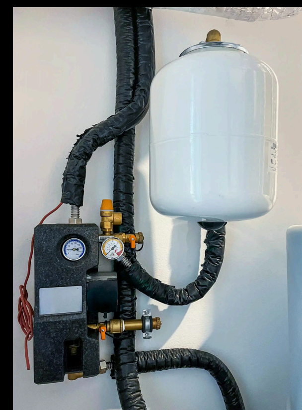
Solare termico e centralina rilancio
