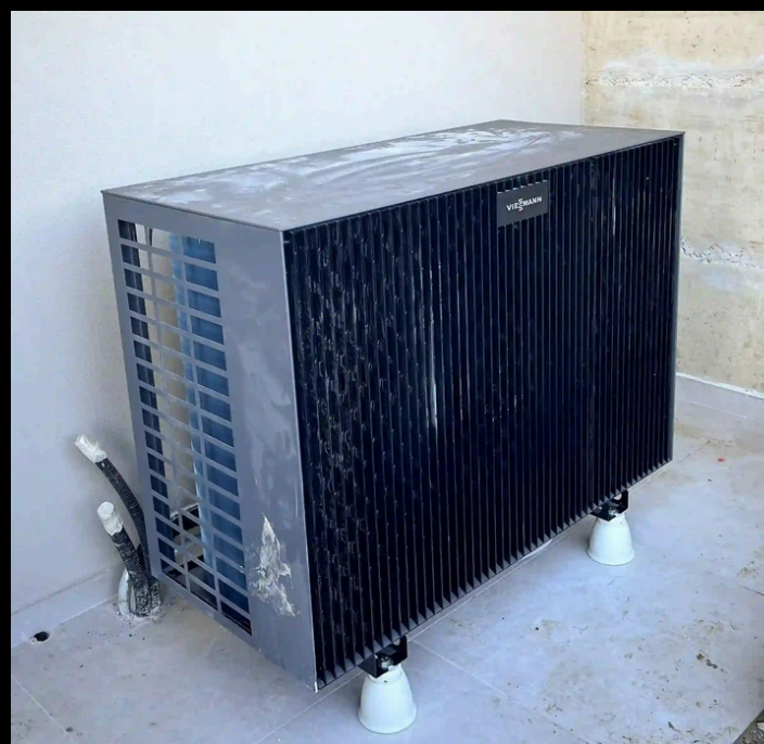
Centrale termica e pompa di calore
