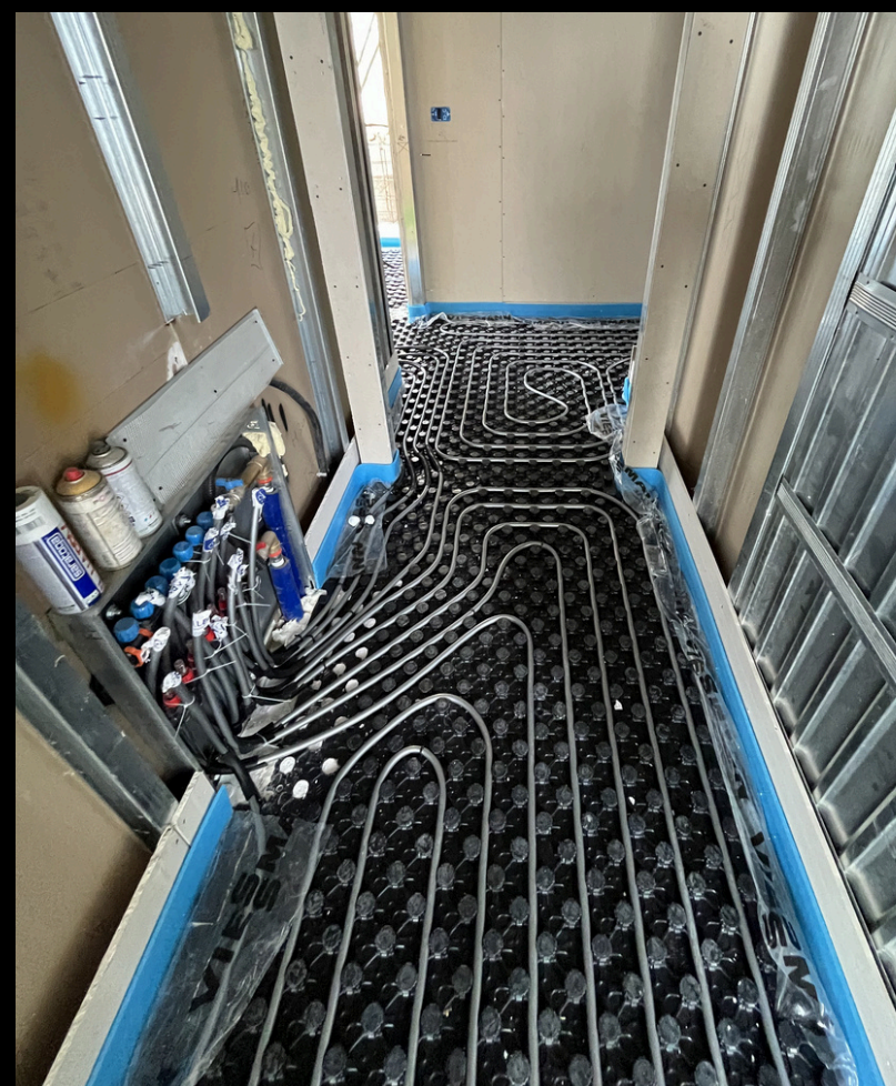
Impianto a pavimento
